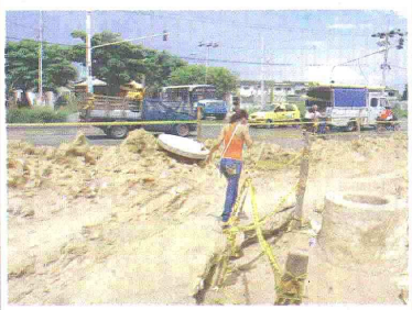
EL estado de la vía es tal que la comunidad ha tenido que abrir caminos para pisar en firme porque las aguas lluvias estancadas han hecho verdaderos pantanos en los que se hunden los pies de quienes por allí pasan
