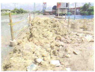
¡HASTA cuando tendrán que esperar los habitantes de la urbanización La Arboleda y sus alrededores por el arreglo de una de sus vías de acceso, cuyas obras están paralizadas afectando el tránsito por la misma?
