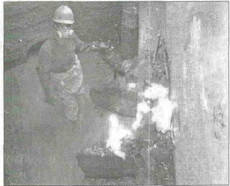
GRAN CANTIDAD de basuras y escombros fueron encontrados al momento de destapar el colector de aguas negras que queda ubicado al lado del río del Oro.
