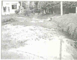
ASÍ SE ENCUENTRAN algunas calles en Pivijay, donde el fuerte invierno ha generado erosión y deterioro en esta localidad, llegando incluso en muchos casos a dificultar el tránsito vehicular.
